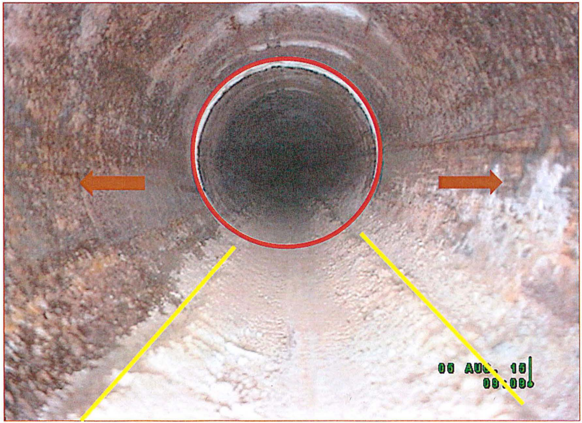
Abbildung 2: Position des Kamerakopfs bei 0,00 m , Übergang (roter Kreis) vom Standrohr (braune Pfeile) zum Injektionsmörtel, Verunreinigung des Standrohrs durch Salzgrus im Bereich von 120° bis 240°(gelb)
